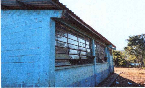
Foto1: La escuela esta deteriorado las paredes en el módulo 2
